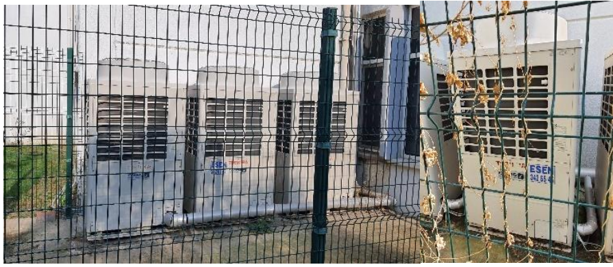
Fotoğraf 2 Zemin Katta Bulunan Vrf Dış Üniteleri
